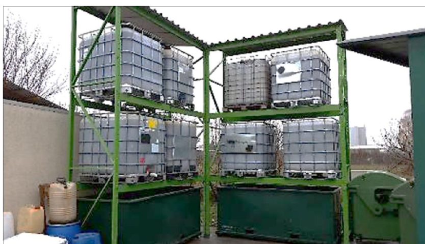
IBC spremnici s otpadnom vodom iz procesa sterilizacije
