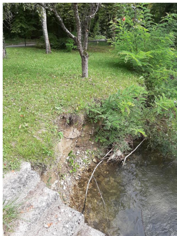
vodotok Lipovečka Gradna u stac. 5+112 erodirana obala
