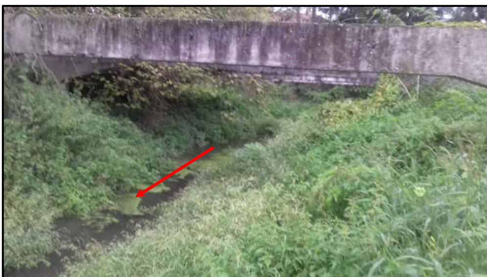
Slika 2.1-3. Predmetna dionica potoka Sutlište, stac. km 2+005 do stac. km 2+017, s vidljivom AB konstrukcijom iznad korita i označenim smjerom tečenja (izvor: Viacon, 2019. )
