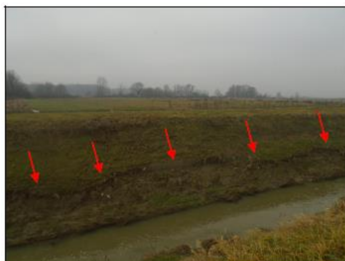
Slika 2.2.1.-5. Plitki (površinski) linijski odron na dužini cca 80 m, u dnu desne obale rijeke Lonja
