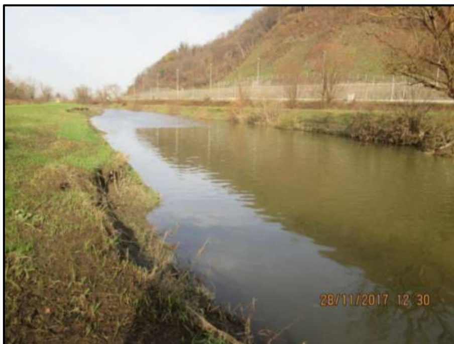
Slika 2.1-2. Okvirni izgled profila korita vodotoka Krapina koji je predviđen za sanaciju - lijevi pokos je erodiran u duljem potezu ( izvor: VIACON, 2017. )
