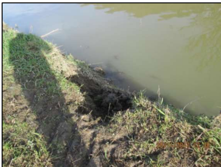
Slika 2.1-3. Lokalna nestabilnost pokosa na vodotoku Krapina ( izvor: VIACON, 2017. )
