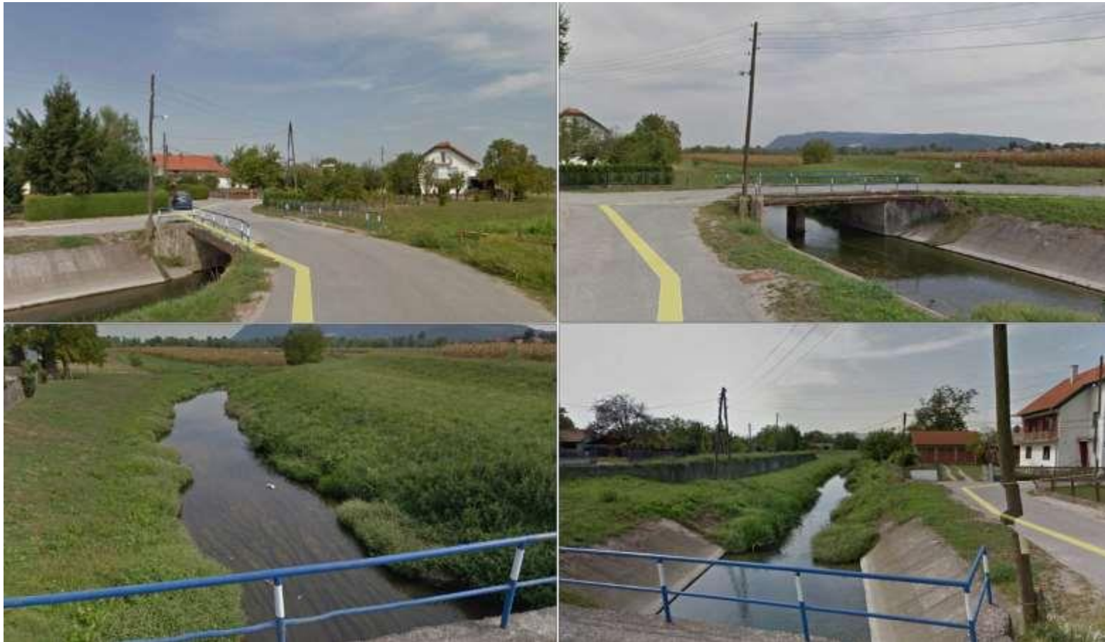
Slika 2.2.-1. Fotografije lokacije zahvata – Most u Rakovici i zaštitni zid u Prelcima, gore lijevo – pogled prema S, gore desno – pogled prema J, dolje lijevo – pogled prema SI, dolje desno – pogled prema JZ (listopad 2017., Google Earth)
