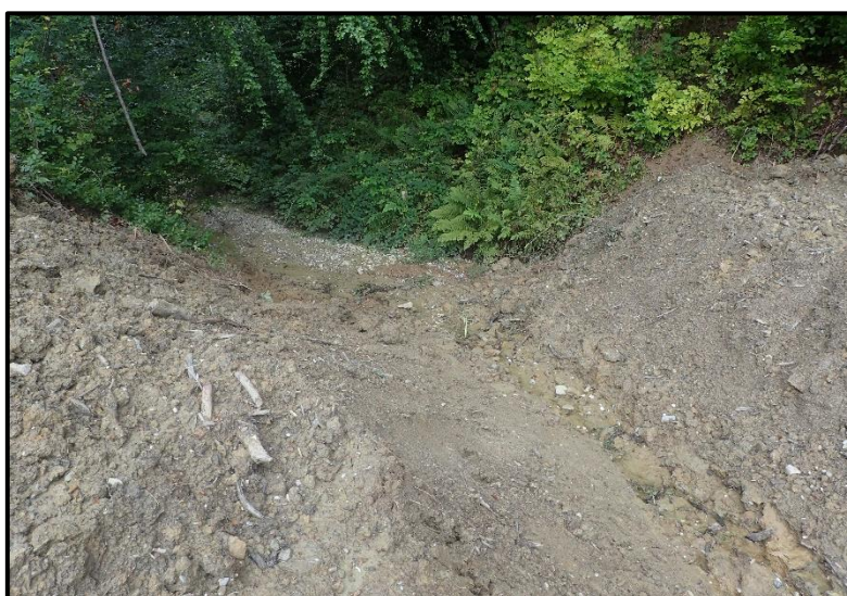
Slika 2.1-8. Strmi dio korita nizvodno od retencije – mjesto predviđeno za AB stepenicu (izvor: Viacon, 2019. )
