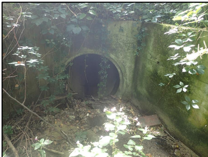
Slika 2.1-2. Početak trase, ulaz u betonski cijevni propust u županijskoj cesti ŽC3034 (izvor: Viacon, 2019.)
