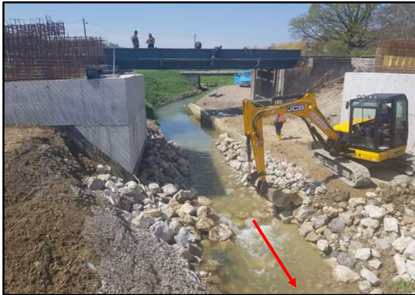
Slika 2.1-6. Radovi na izvedbi obloge korita uz upornjake novog željezničkog mosta, s označenim smjerom tečenja (izvor: Viacon, 2019.)
