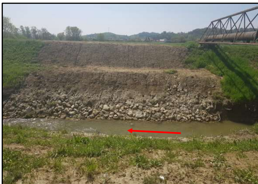
Slika 2.1-3. Sanirani odron desnog pokosa nizvodno od magistralnog vodovoda, s označenim smjerom tečenja (izvor: Viacon, 2019. )
