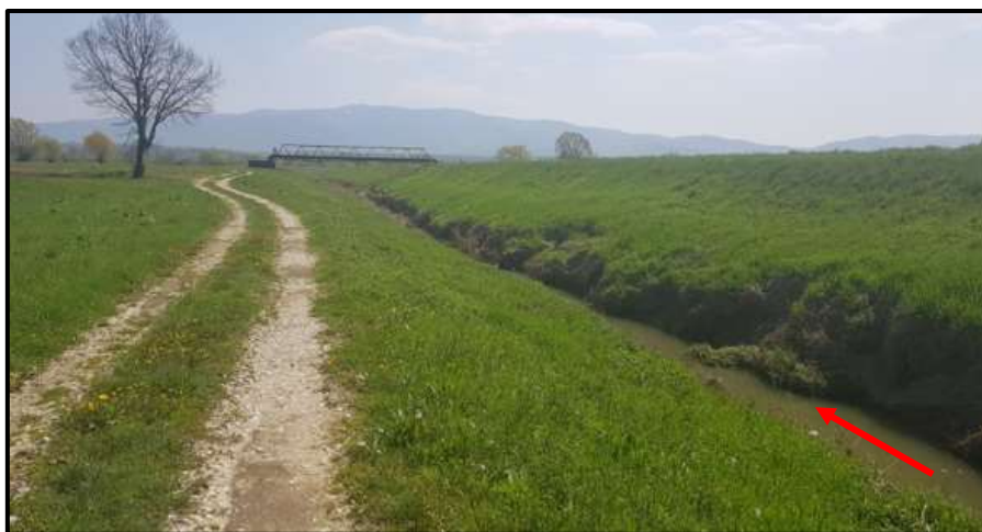
Slika 2.1-2. Lokalne nestabilnosti i odroni pokosa na desnoj obali, pogled prema magistralnom vodovodu, s označenim smjerom tečenja (izvor: Viacon, 2019. )
