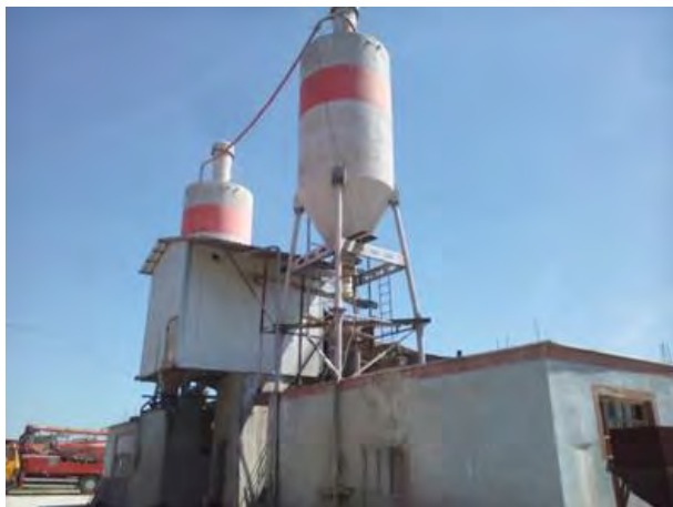
Silos za cement, miješalica i upravljačke kabine
