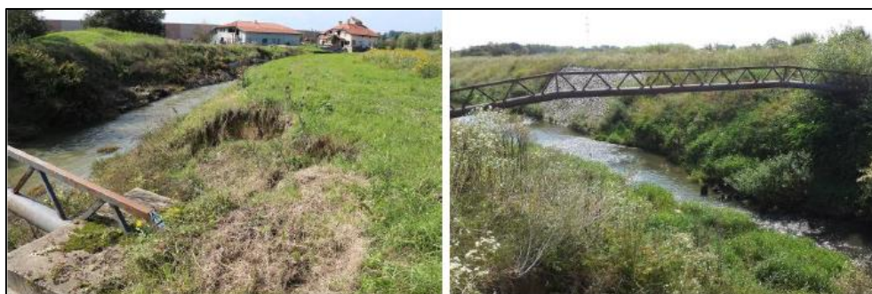
Slika 2.2.1.-4. Oštećenje uz postojeći cjevovod
